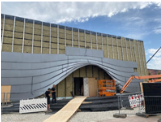
Um die schräge Verkleidung der übereinandergelegten „Schuppen“ zu erreichen, verlegten die Fassadenbauer die Elemente ähnlich wie Schindel und Mauerstein versetzt überlappend. Foto: Chardonnerie du Ried
