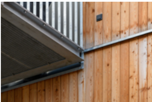
Stahlbalkon trifft auf Holzkonstruktion: Die komplexe Herausforderung der thermischen Trennung und trittschalldämmenden Entkopplung lösten die Planer über eine eigens entworfene Stahlbau-Sandwichkonstruktion mit Schöck Isokorb T Typ S. Foto: Moritz Bernouilly
