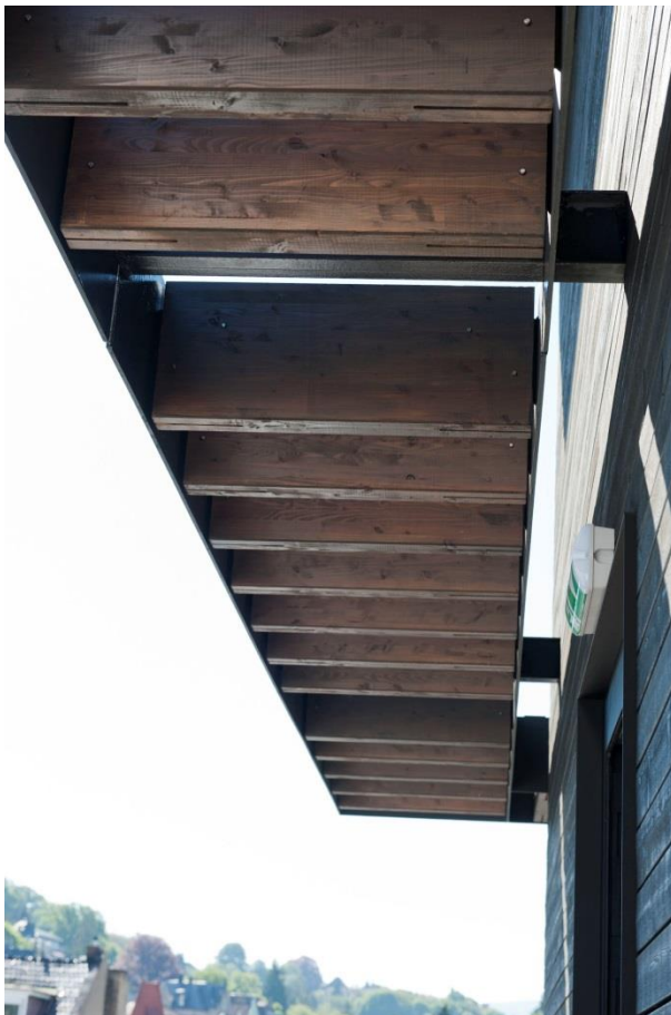
Ohne die verbauten Schöck Isokorb Typ KS Elemente wäre es schwierig bis unmöglich geworden, die Vordachkonstruktion in der ausgeführten Leichtigkeit zu konstruieren und die bauphysikalisch problematische Wärmebrücke am Anschluss an die Stahlbetondecken zu entkoppeln. Foto: Schöck Bauteile GmbH, Abdruck honorarfrei.
