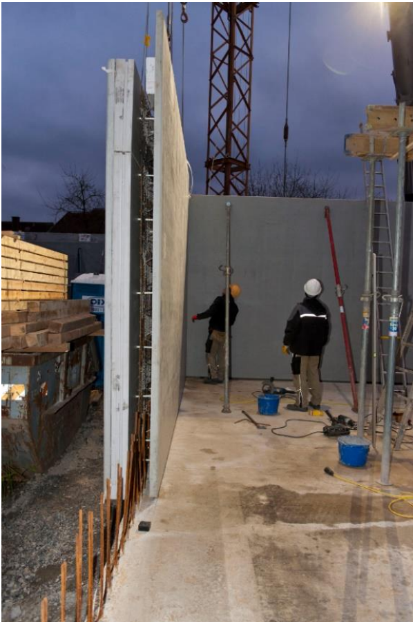
Aufstellen und Ausrichten der frei hängenden Elementwände. Foto: Schöck Bauteile GmbH, Abdruck honorarfrei.
