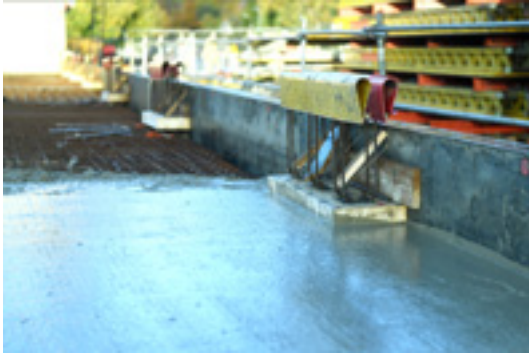
Der Einbau des Sconnex Typ W erfolgte vor Ort auf der Baustelle. Foto: Schöck Bauteile AG
