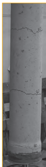
Deuxième fissure (300 N/mm 2 )
