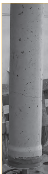
Première fissure (150 N/mm 2 )
